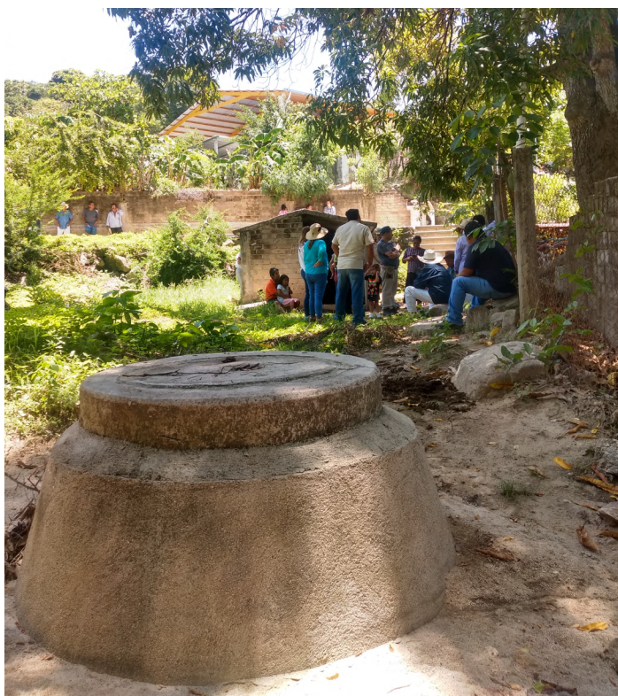
Figura 5. Infraestructura de saneamiento inconclusa y mal ubicada en proximidades de un manantial comunitario en un pueblo zapoteco de Pinotepa Nacional, Oaxaca. Fotografía de Mayrén Alavez Vargas.
