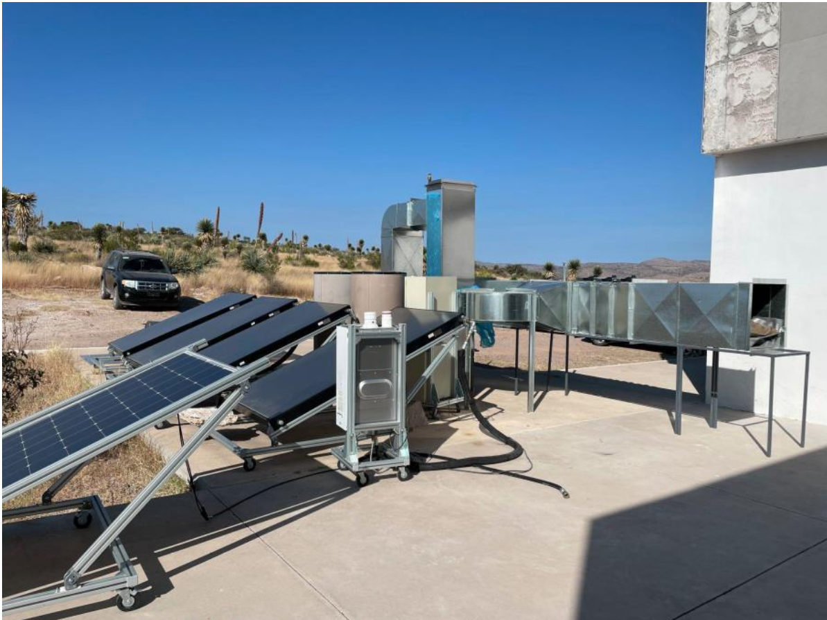
Figura 6.9.- Equipo ya instalado y acoplado al sistema solar modular de captación y almacenamiento de energía
